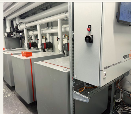
Herzstück der Geothermie-Nutzung: die intelligente FabriCar-Energiezentrale mit vier Wärmepumpen
