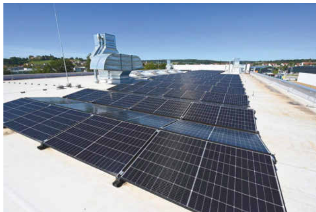
Uthoff KLS ist nach KfW-Standard 55 zertifiziert, verfügt über ein Blockheizkraftwerk, eine Photovoltaik-Anlage und eine Wasseraufbereitungsanlage. (Foto: M. Rehm)
